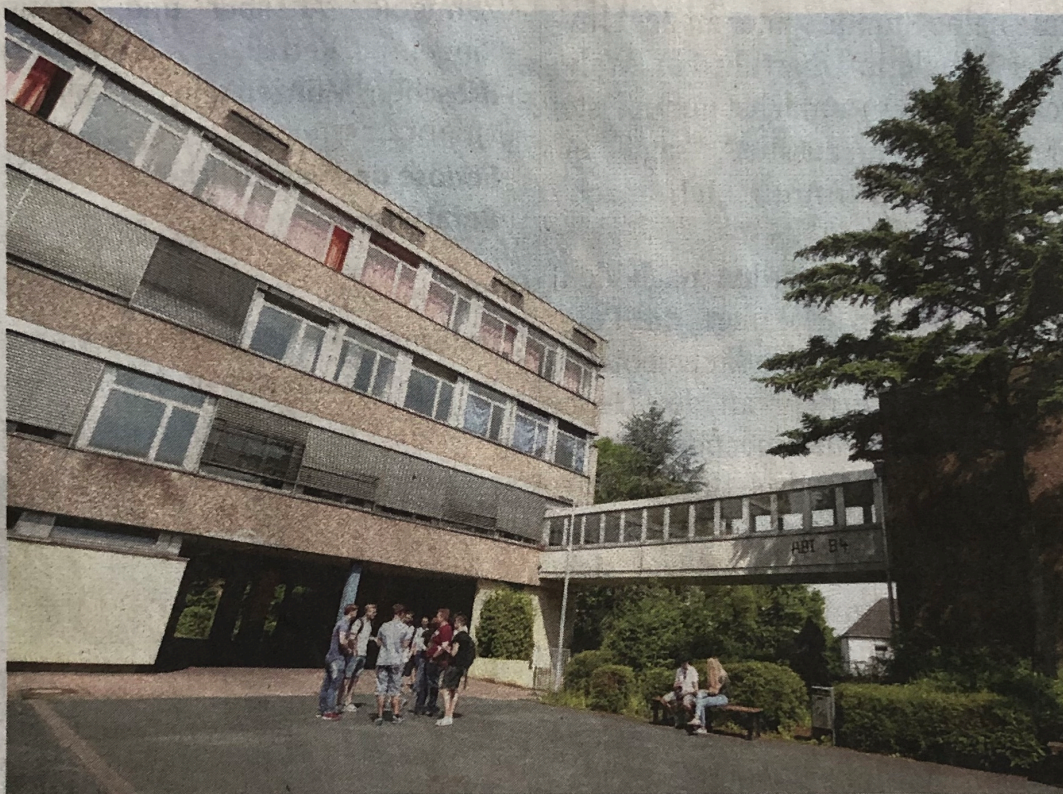
An der Fassade lösen sich Waschbetonplatten: Die ehemalige Gesamtschule Süd wird jetzt erst einmal zur Baustelle.
